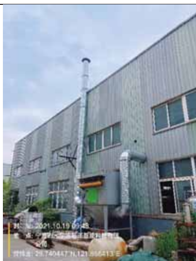
切割粉尘滤筒除尘器
