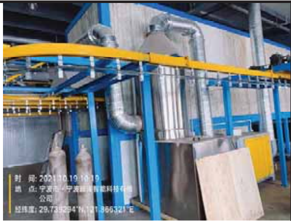
喷塑烘道废气处理设施
