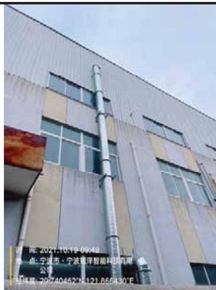
注塑废气排放口
