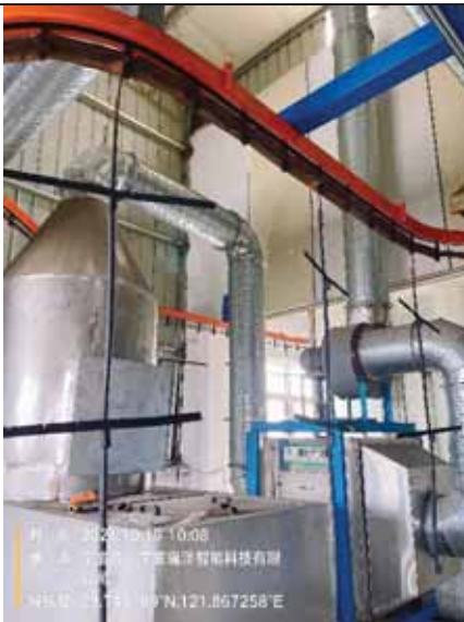
喷塑烘道废气处理设施
