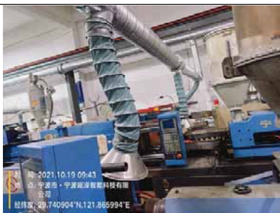
注塑车间废气收集管
