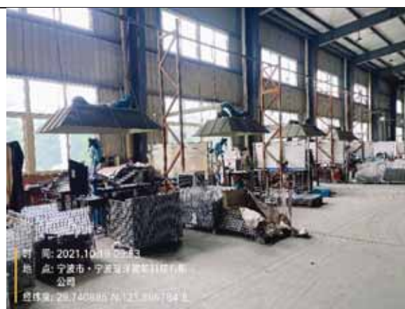
焊接烟尘集气罩（租用厂房）
